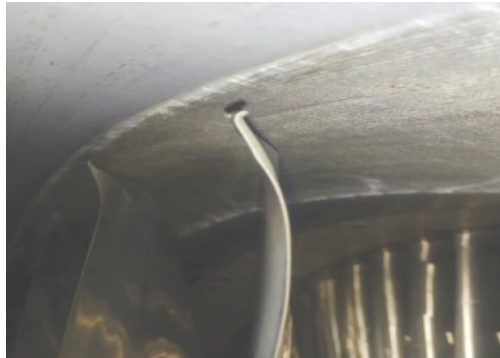
Рис. 1. Характерный дефект лопатки вентилятора при задевании
