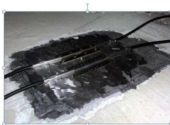
Рисунок 2.33. Датчики деформации и температуры, установленные на затяжке.
