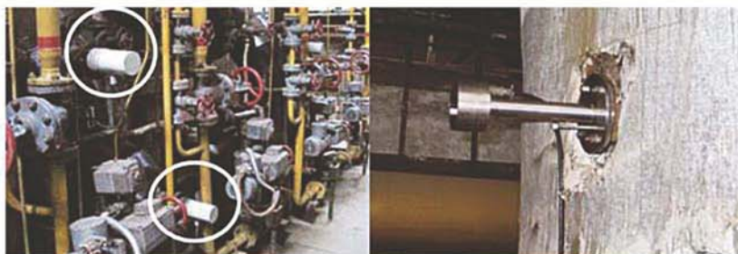
Устройства контроля факела и газоанализатор O 2 на энергоблоке тепловой станции
