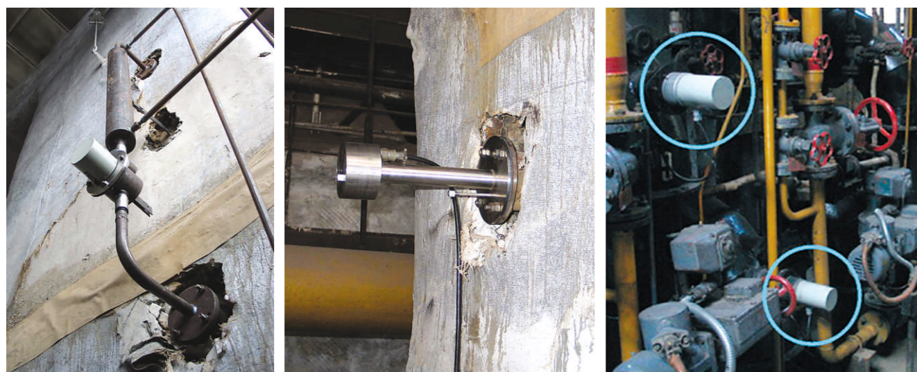
Газоанализаторы водорода, кислорода, датчики факела на тепловой станции ТС-1.
