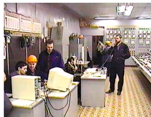
Испытания аппаратуры на ПР ТЭЦ Уренгойской ГРЭС.
